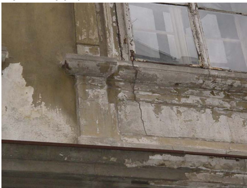
Slika 7-1. Pukotine u staroj kući u Zagrebu zbog kojih su stanari preseljeni u hotel na trošak izvođača. Pukotine su primijećene nakon izvedbe duboke građevne jame u neposrednom susjedstvu, izvedene da zbog produbljenja podruma tj. proširenja korisnog prostora susjedne ugostiteljske radnje. Fotografirao ing. Zvonko Čikeš.
